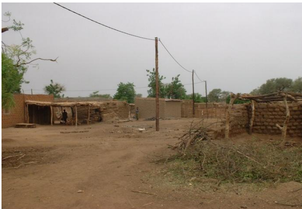
Réseau électrique BT
